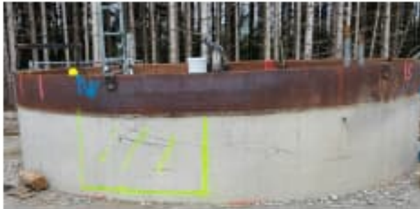
Bildunterschrift Bild 2: Schacht des Horizontalfilterbrunnen der Stadtwerke Landsberg KU. (Foto: Stadtwerke Landsberg KU, zum Abdruck frei)
